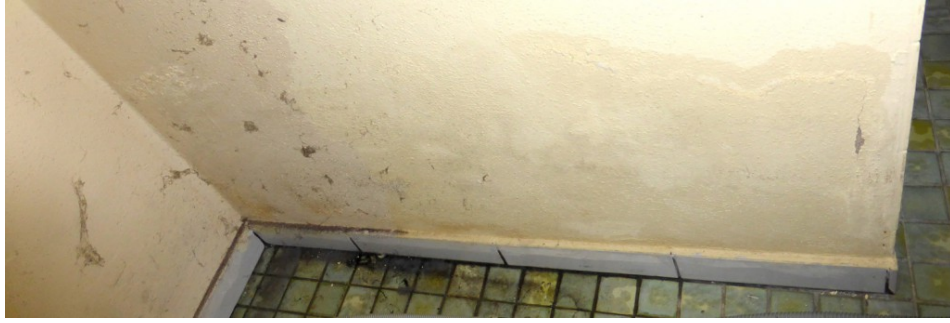
Feuchte Wände und Wasser im Keller der Familie Schempp in Landwasser (Foto: M. Schempp)
