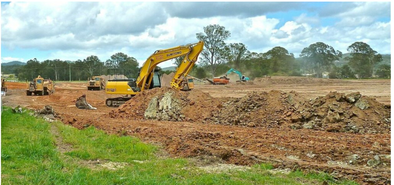
Nun wurde im Wasserschutzgebiet gerodet und gebaut: bis heute ohne Baugenehmigung! (Foto von Siggy Nowak auf Pixabay)
