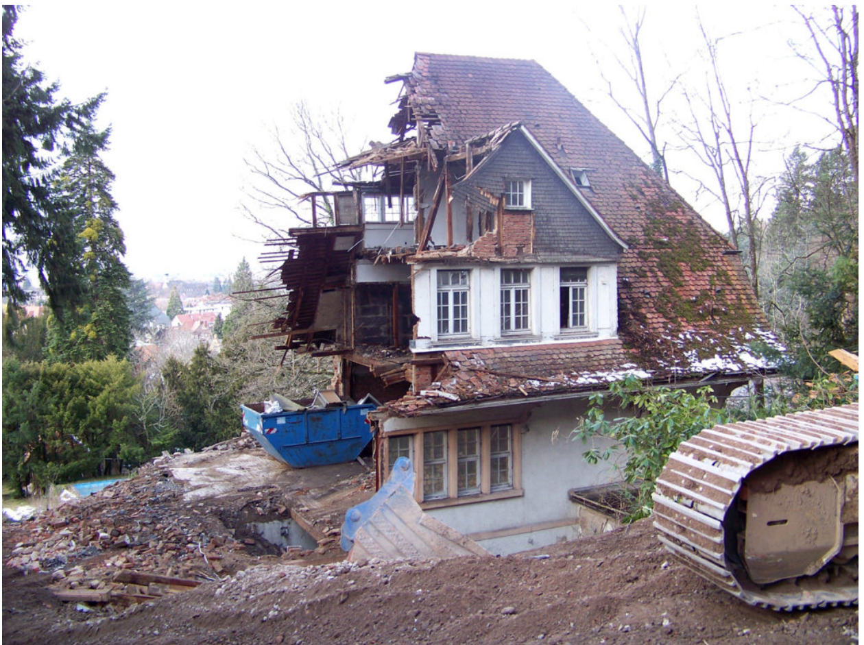
Das Haus in der Wintererstraße 28 stand unter Denkmalschutz, wurde aber dennoch mit fadenscheinigen Beründungen abgerissen! (Foto: H. Sigmund)
