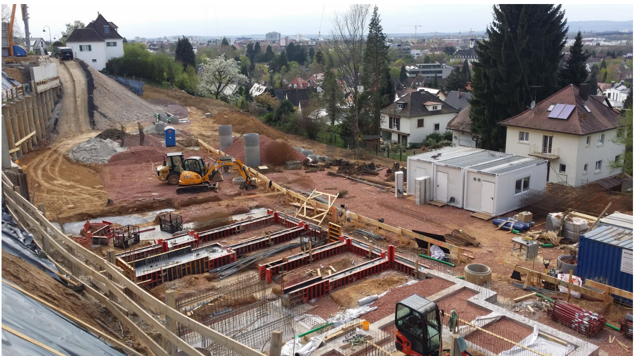
Die Baustelle auf dem Gelände der ehem. Pferdewiese in der Sonnhalde: Dies war einer der letzten weiten Ausblicke von den Herdermer Hängen auf die Stadt.
