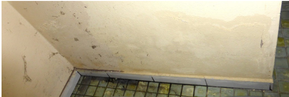
Feuchte Wände und Wasser im Keller der Familie Schempp in Landwasser (Foto: M. Schempp)
